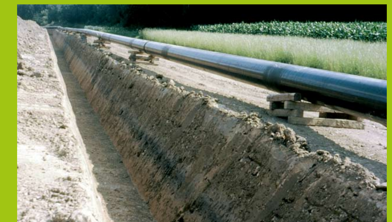
Bild 3 – Die Verlegung der Gaspipeline erfolgte im Jahr 1985. Ihr Verlauf ist an den orangenen Tafeln auf gelben Pfählen erkennbar. In ihr wird Erdgas u. a. aus Sibirien bis nach Zußdorf unterhalb des Höchsten geleitet und in einer unterirdischen Gesteinsschicht in einer Tiefe von ca. 1.500 m gelagert.
